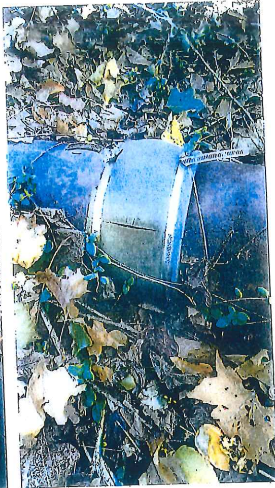
Rotten Fernco coupling
